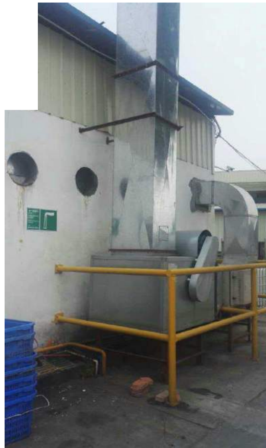
油烟废气治理设施
