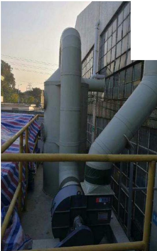
注塑废气治理设施
